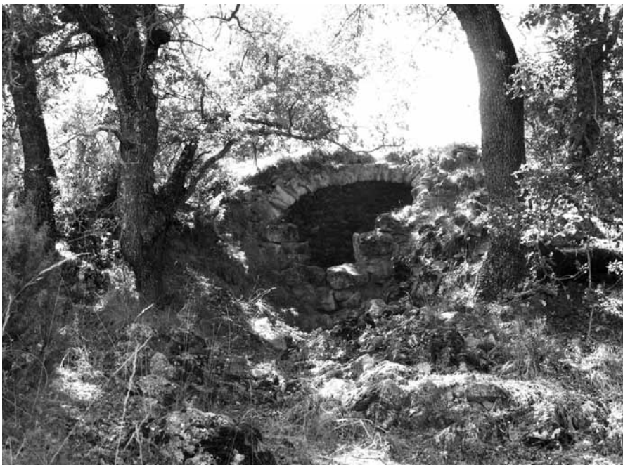
FIGURA 14: Vista general del pozo nevero del Seganter. Se observa la parte de bóveda hundida
