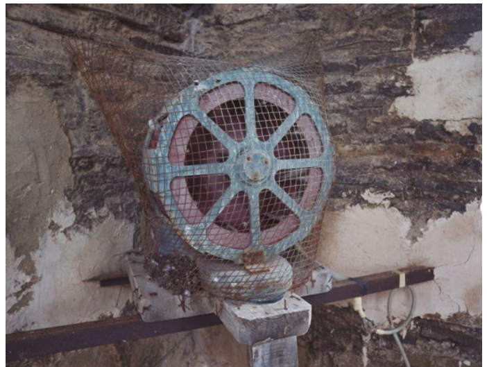
Figura 61: Sirena instalada en la iglesia de Azanuy
