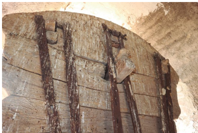
Figura 55: Detalle del cabezal de la campana grande de la iglesia de Camporrells, con tirantes fijados por medio de cuñas y pequeñas piezas metálicas
